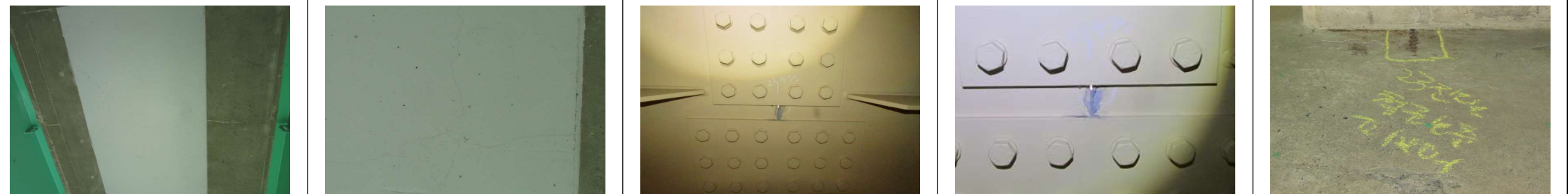
바닥판 S2 보수부 망상균열
