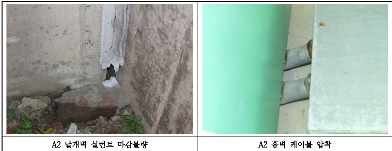
【사진 3.12】교대 손상현황(계속)
