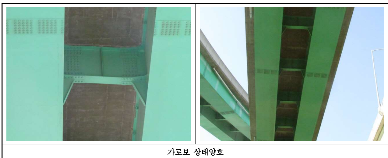
【사진 3.10】 2차부재(가로보) 손상현황
