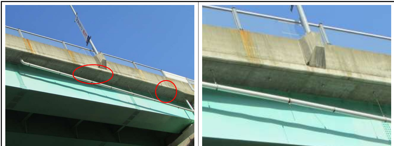
S4 배수관 고정대 탈락(3개소)
